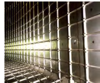
图 3 薄膜型储罐内部
